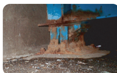
土砂堆積常時湿潤状態
